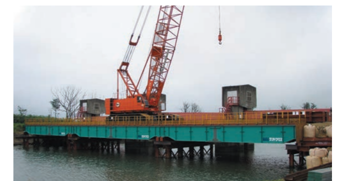
宮城県/貞山堀防潮水門旧施設撤去工事 幅員:8.0m、橋長:50.0m(3径間)
