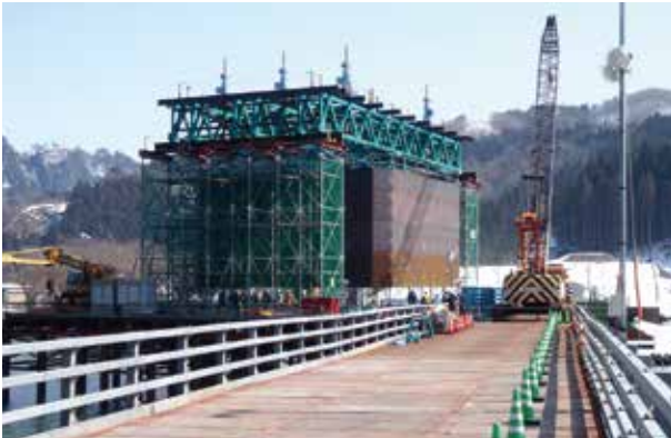
事例1：ニューマチックケーソンの吊下げ用架台
