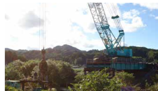
岩手県/一般国道106号宮古西道路長沢川橋梁下部工工事 幅員:8.0m、橋長:16.0m
